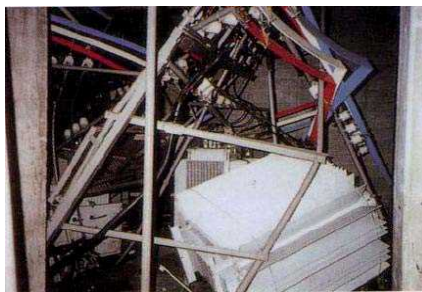
شکل ۹-۷ واژگونی مبدل (ترانسفورماتور) در تأسیسات برقی روباز
