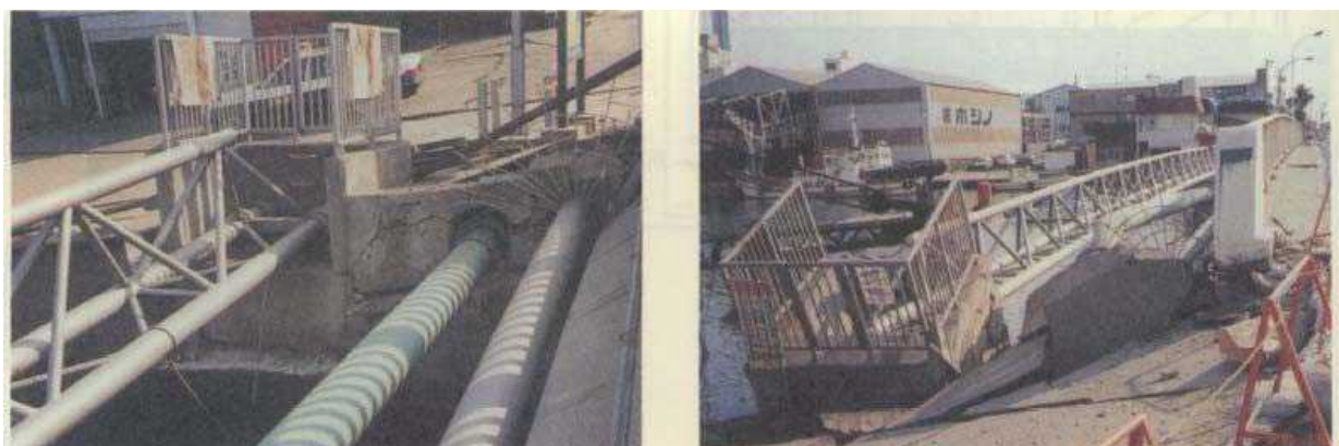
شکل ۷-۲ آسیب خط لوله به علت خرابی پل بر اثر روان گرای وسیع
