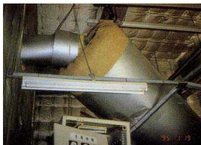
شکل ۹-۵ آسیب دیدگی عایق صدا
