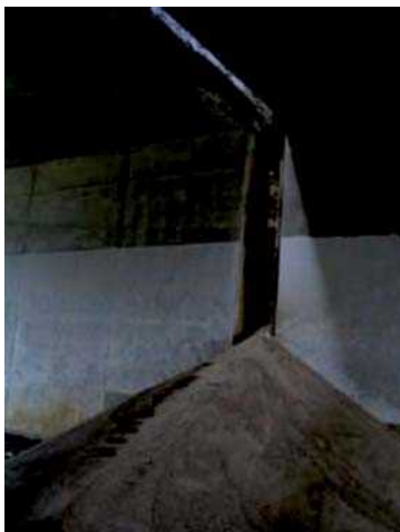
شکل ۱۰-۲ درز ایجاد شده در کالورت با مقطع مربعی در اثر زلزله
