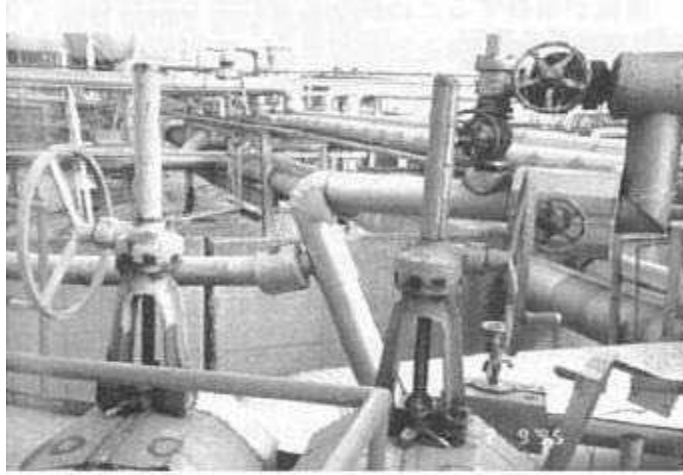
شکل ۵-۱ خرابی در لوله‌های با قطر کم
