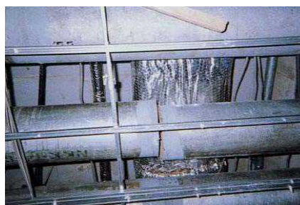
شکل ۹-۳ آسیب دیدگی لوله کشی خنک کننده آب. (در اثر نیروی لرزه‌ای جانبی قسمت جوش شده لوله دچار آسیب دیدگی شده است)
