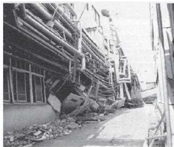
شکل ۵-۴ صدمه به سیستم لوله‌کشی در اثر خرابی ساختمان
