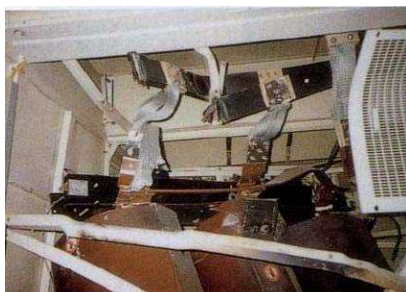
شکل ۹-۸ آسیب دیدگی قسمت‌های اطراف ترانسفورماتور
