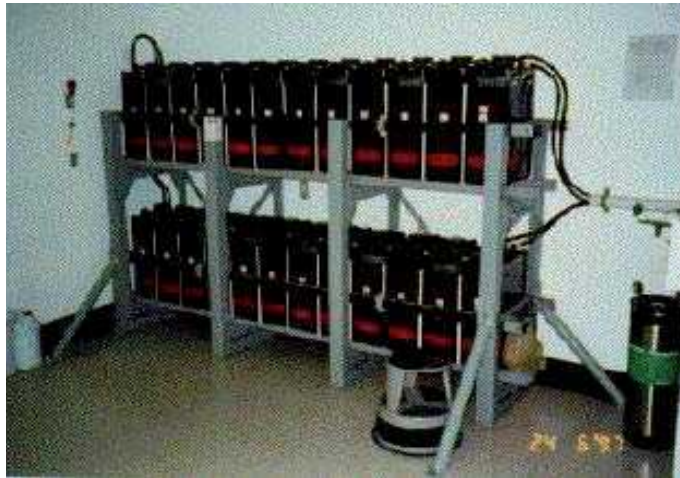
شکل ۱۰-۵ مه‌ار بندی قفسه باتری‌ها جهت کنترل واژگونی
