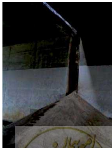
شکل ۷۳-۵ درز ایجاد شده در مجرای بتنی با مقطع مربعی در اثر زلزله
