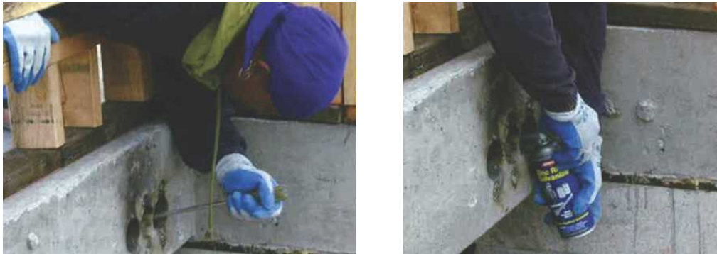
شکل ۶-۳۸- خارج کردن مواد اضافی از حفرات کشش و اسپری مواد ضد خوردگی مانند گالوانیزه‌کننده با پایه روی ۱ جهت محافظت بیشتر بر روی قسمت انتهایی تاندون
